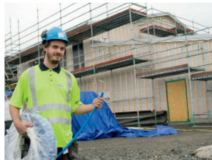
Jonathan Henriksson, ledande montör på förskolebygget, ska tillsammans med ytterligare en eller två elektriker installera all el.
