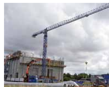
Panncentralen Varberg Energis största investering någonsin.
