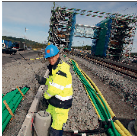
Anders Andersson – i inledningskedet med arbete på perrongerna. Nu förlängs jobbet även med installationer av trapphusen i bakgrunden
