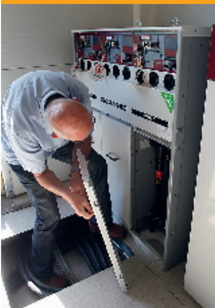
Allt ok i högspänningsställverket?
