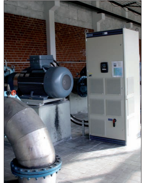
...klar att installeras i VA-verket.
